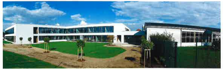
Abbildung 2: Schulgebäude mit Anbau (Bestand rechts): Schadenort Fußboden EG ca. Bildmitte, stehendes Wasser auf Abdichtung der Bodenplatte im gesamten Gebäude.
